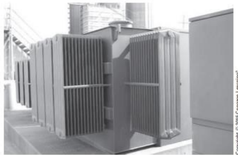
GAMBAR 2-40 Trafo yang dipasang di bantalan dengan sirip pendingin eksternal.
