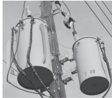
GAMBAR 2-27 Salah satu transformator lebih besar dari yang lain.
