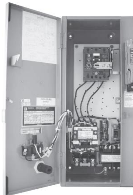
GAMBAR 8-9 Starter kombinasi berisi pemutus sekering atau pemutus sirkuit, trafo kontrol, dan starter motor dalam satu penutup.
