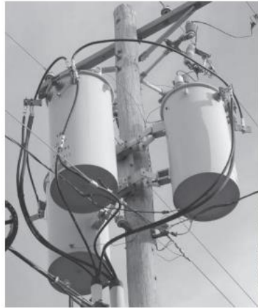
GAMBAR 2-22 Trafo satu fasa dipasang pada sebuah tiang dan dihubungkan untuk membentuk bank 3 fasa.
