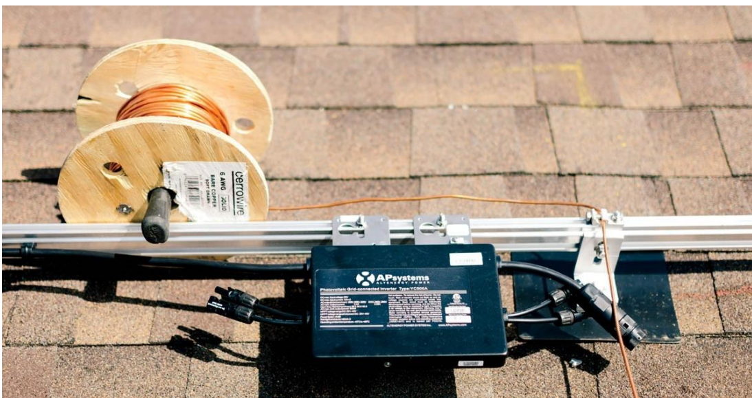
Gambar 3.22 Inverter mikro biasanya dipasang ke rak di bawah modul. Mikroinverter ini terhubung ke dua modul. Kabel yang lebih berat menghubungkan mikroinverter bersama-sama.
