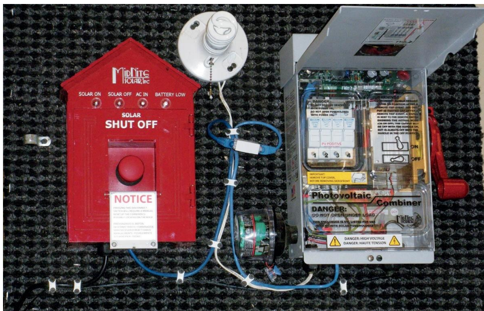
Gambar 8.9 Pengaturan demonstrasi ini menunjukkan kotak kontrol pemadaman cepat Birdhouse di sebelah kotak penggabungan pemutus. Kabel biru adalah kabel Cat-5, yang mengirimkan sinyal trip antara kotak kontrol dan pemutus.
