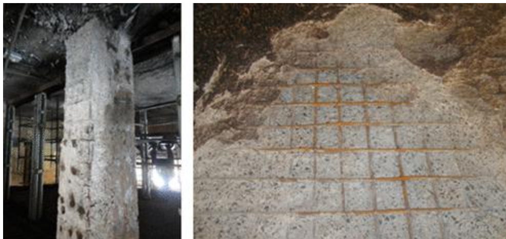
Gambar 6.1: Contoh kerusakan akibat kebakaran yang luas pada bangunan beton bertulang yang menunjukkan (a) spalling, (b) tekuk kolom, dan (c) retak luas pada soffit di sepanjang garis tulangan.
