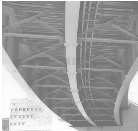
Gambar 6.2 Tampak bawah jembatan gelagar I yang melengkung.
