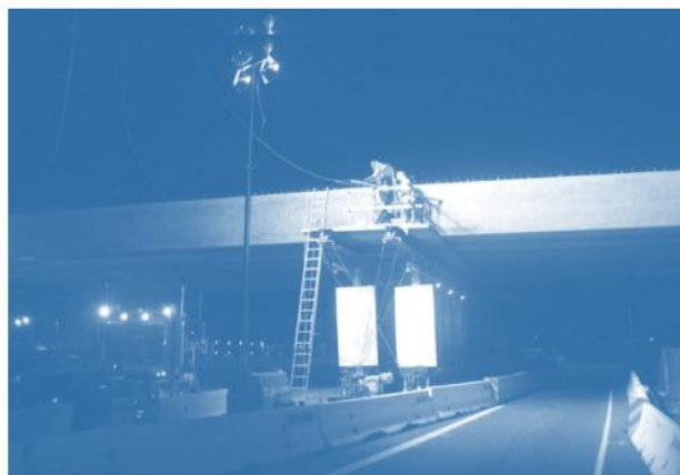
Gambar 1.10 Segmen gelagar bak mandi pracetak disambung dekat bentang tengah menggunakan penyangga sementara di Harbor Blvd. OC di California.
