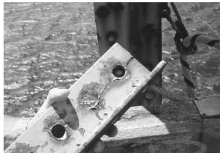
Gambar 9.7 Sudut Sambungan Dari Balok Memanjang Ke Sambungan Balok Lantai Jembatan Di Atas Sungai St. Croix Di I-94 Yang Retak Karena Terlalu Kaku.
