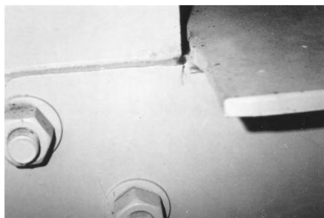
Gambar 9.8 Tampilan Close-Up Dari Retakan Yang Berasal Dari Ujung Flensa Pada Balok Lantai Dengan Sambungan "Sederhana" Ke Pelat Pengikat Di Jembatan Dresbach Di Minnesota. Retakan Tersebut Merupakan Indikasi Momen Ujung Pada Sambungan Sederhana Yang Tidak Diprediksi Dalam Desain.
