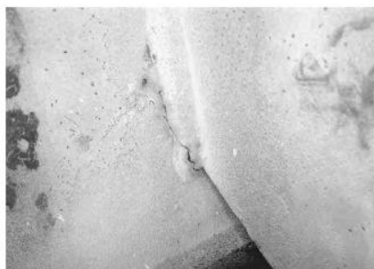
Gambar 9.6 Tampilan Retakan Pada Las Fillet Yang Menyambungkan Pelat Penghubung Diafragma Ke Web Penampang Kotak Pada Struktur Layang Washington Metro. Retakan
