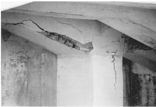
Gambar 4.20 Jembatan Beton Bertulang Tipikal Yang Rusak Akibat Korosi.
