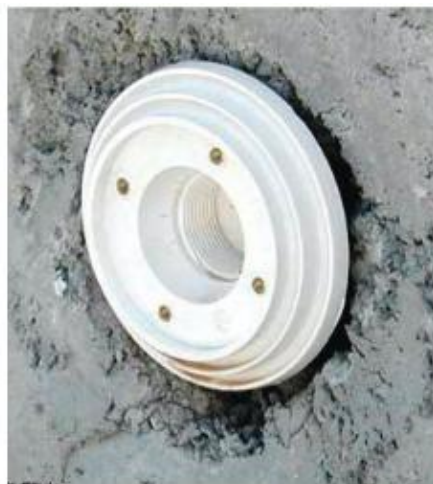
Gambar 4.7 Port pengembalian pada kolam renang cangkang beton.
